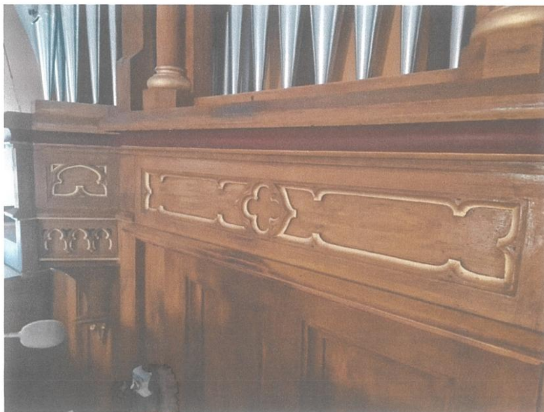
2. Nierównomierne wyblyszczczenia lakieru partii cokołowej prospektu.
