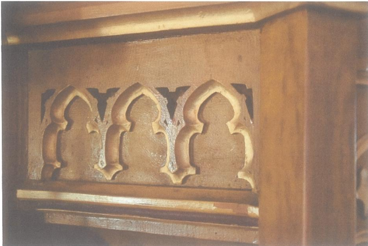
6. Uszkodzenia drewna, nierównomierne wyblyszczenia i zacieki lakieru zabezpieczającego powierzchnię.
